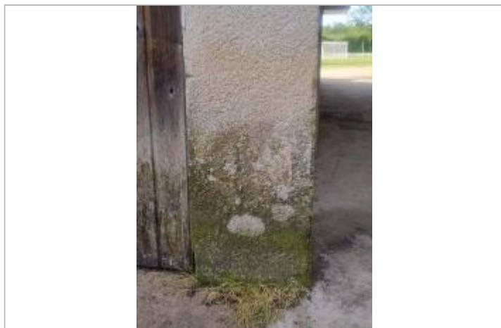
Vue sur la laisse d'inondation
