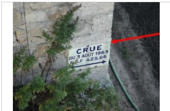
vue du repère sur le mur de la maison sous le pont
