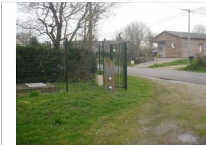
Poteau près de la station de relèvement à Augrain
