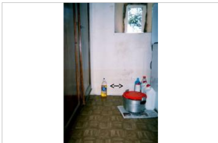
Intérieur de la maison et marque d'inondation de 2001
