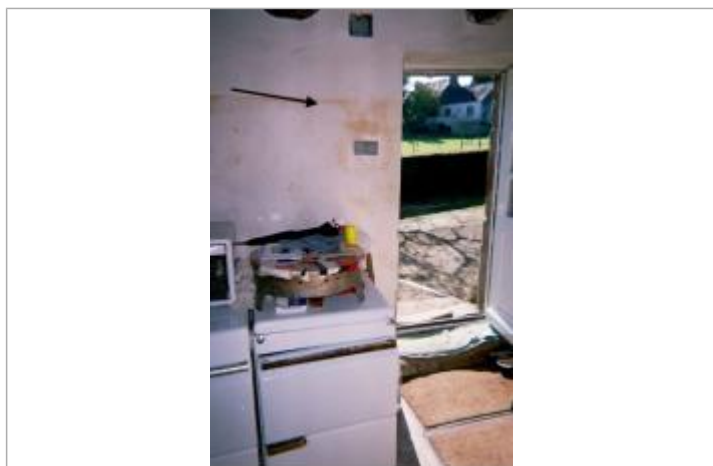
traces d'inondations dans la cuisine
