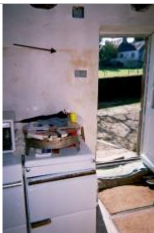
Marque de l'inondation indiquée par le témoin sur le mur de la cuisine
