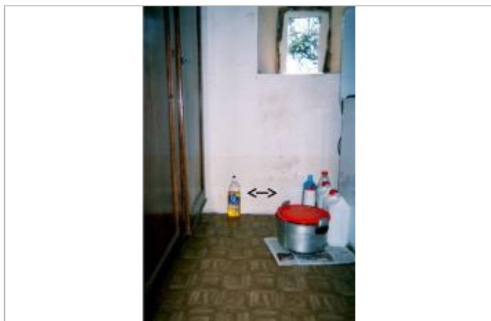
Intérieur de la maison et marque d'inondation de 2001
