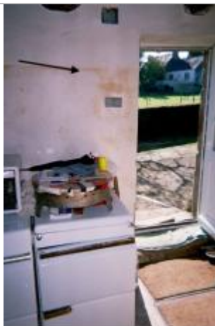
Marque de l'inondation indiquée par le témoin sur le mur de la cuisine
