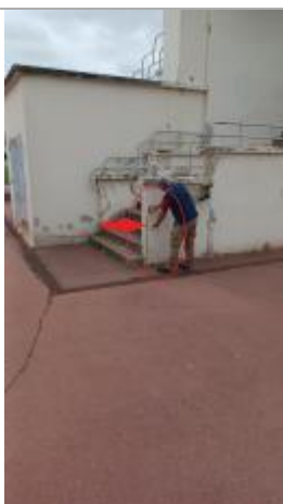
Laisse de crue à 79 cm/sol.
