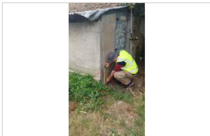
Laisse de crue à 4 cm/sol.
