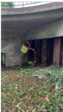
Laisse de crue à 29.5 cm/sol
