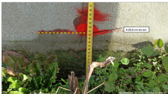
Marque d'humidité (laisse de crue) matérialisée par une marque horizontale de peinture rouge, à 20,6 cm du sol.
