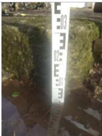
HE_3cm au niveau du bloc (SMBVR)
