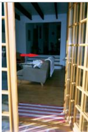
Repère de l'inondation à l'intérieur de la maison, au niveau de la 4 ème marche
