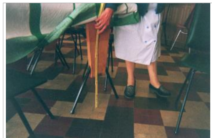
trace de l'inondation de janvier 2001 dans l'habitation
