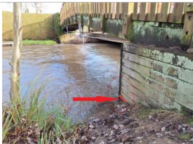
Laisse de crue à 86 cm/haut tablier passerelle (Photo SYMA).
