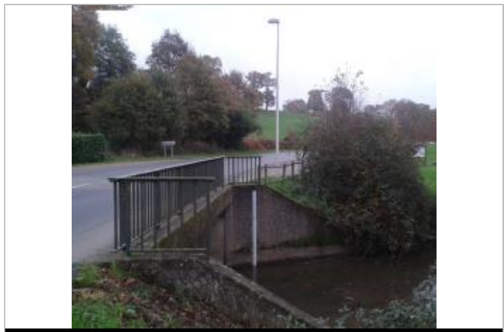
Echelle limnimétrique de la station Vigicrues à Bourg-Barré
