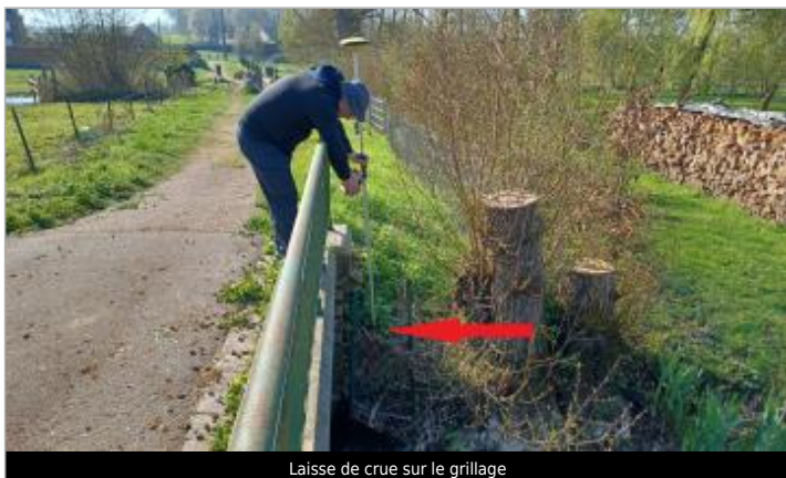
Laisse de crue sur le grillage
