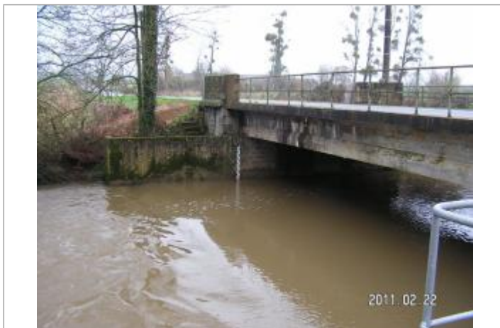
Station limnimétrique du Chevré (Veuvre) - Le Drujeon
