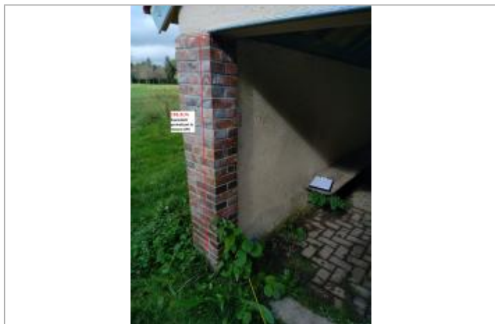
Laisse de crue à 165.5 cm depuis le haut du lavoir (voir photo)
