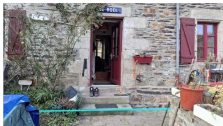
Laisse de la crue de 2025 sur la façade de la maison éclusière - photo Conseil Régional de Bretagne - voies navigable
