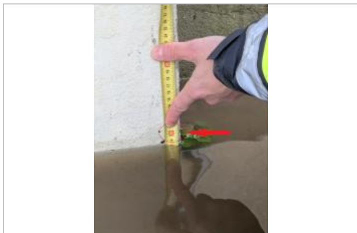
Laisse de crue à 10 cm/sol.
