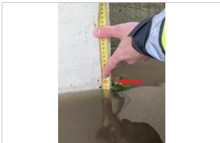
Laisse de crue à 10 cm/sol.
