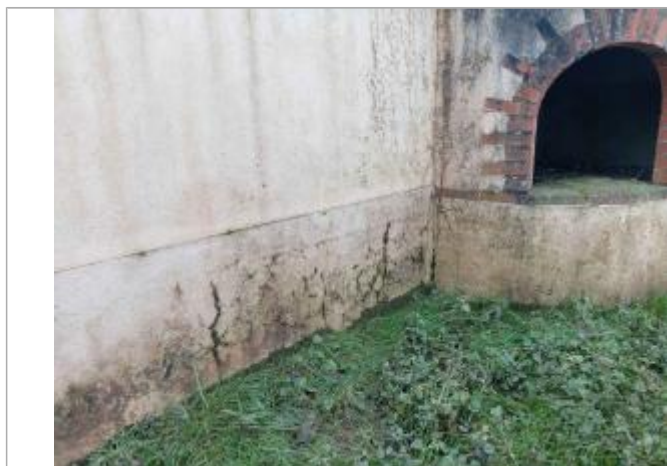
laisse de crue sur mur d'une propriété privée, accessible en bordure de Sarthe
