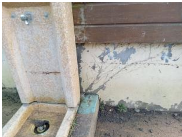
laisse de crue sur mur bâtiment côté camping
