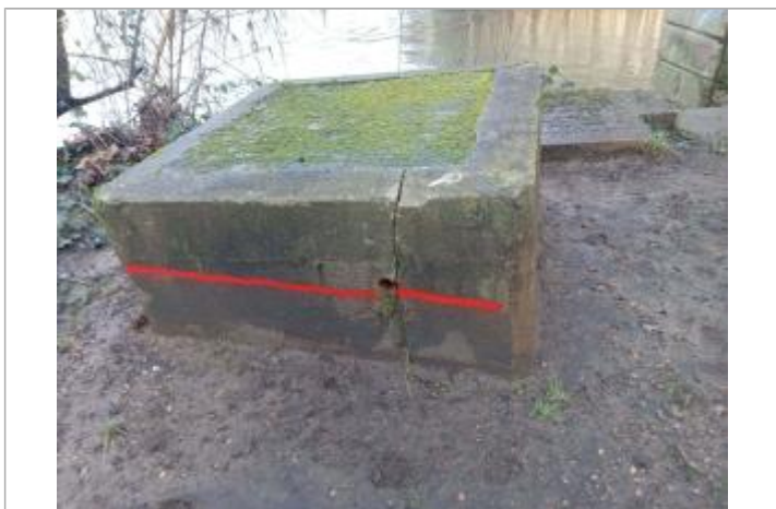
marquage de la laisse de crue à la peinture
