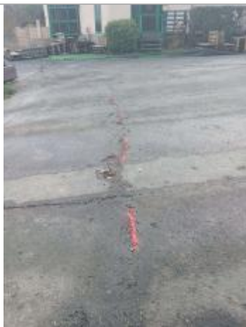
marquage peinture au niveau de la laisse d'inondation
