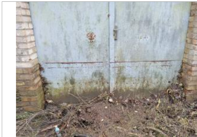
laisse de crue sur portail, à l'extrémité de la parcelle sud du port
