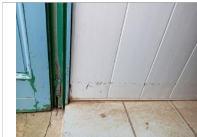
laisse de crue dans les toilettes de la capitainerie
