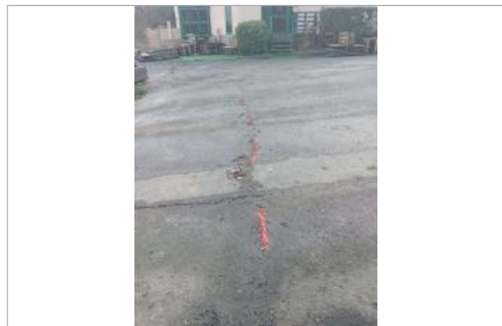
marquage peinture au niveau de la laisse d'inondation
