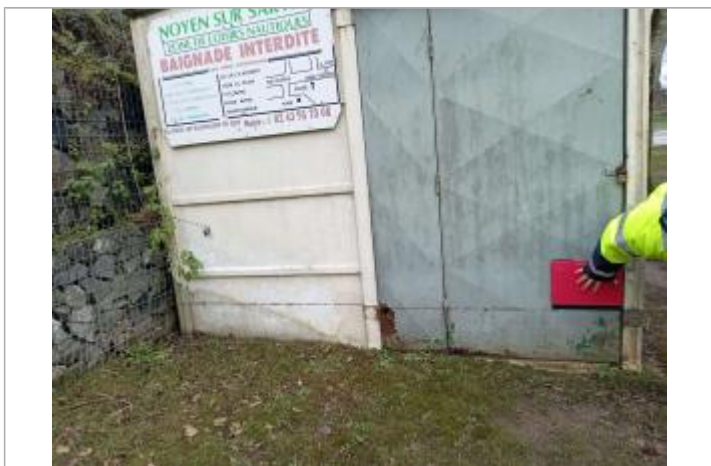
laisse de crue sur batiment de la zone de loisirs
