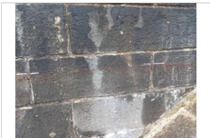
marquage au mur de la laisse de crue
