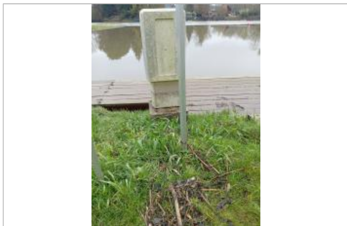
vue d'ensemble de la laisse de crue marquée sur boîtier électrique
