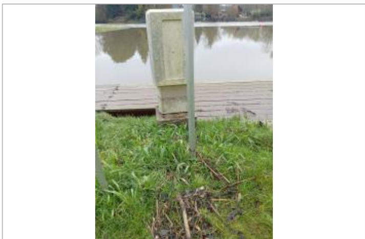
vue d'ensemble de la laisse de crue marquée sur boîtier électrique
