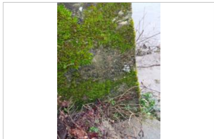
laisse de crue sur l'escalier
