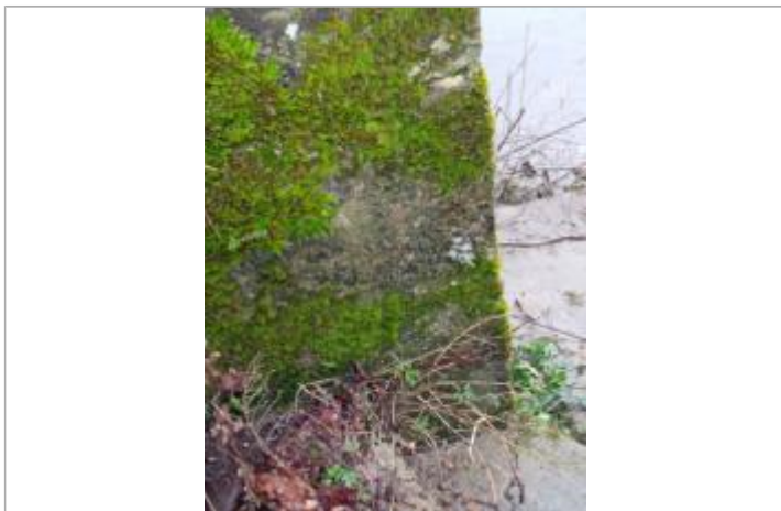
laisse de crue sur l'escalier
