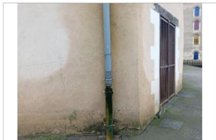
laissé de crue à proximité de la gouttière, marquage
