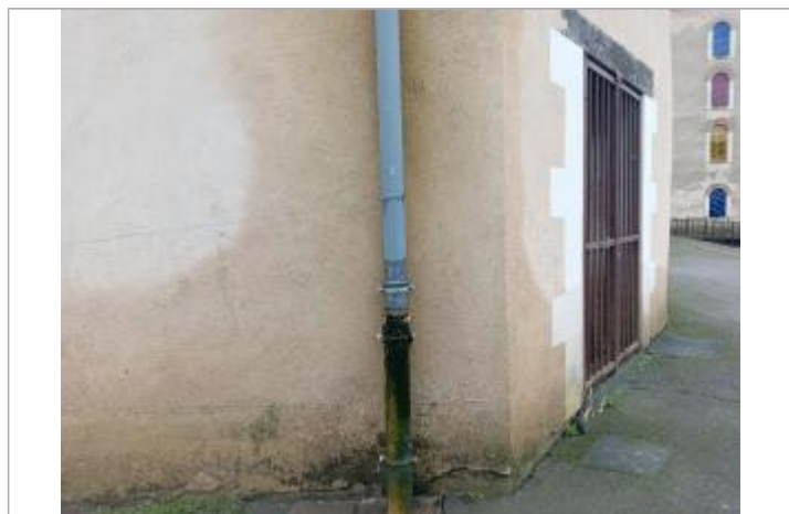
laisse de crue à proximité de la gouttière, marquage
