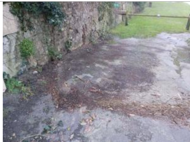
chemin à proximité du moulin (présence d'une laisse d'inondation le jour de la visite)
