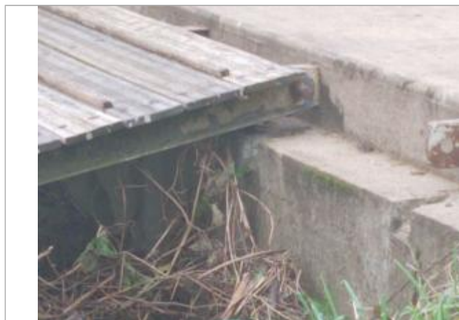
laisses de crue sur le mur
