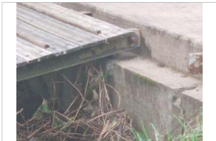
laisses de crue sur le mur
