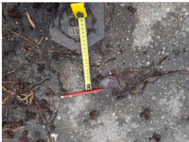
Laisse de crue au sol, à 10 cm de la bouche à clé
