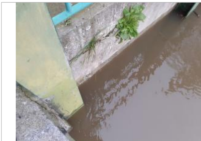
Laisse de crue à 80 cm sous le sommet du mur béton - Photo Caen la mer
