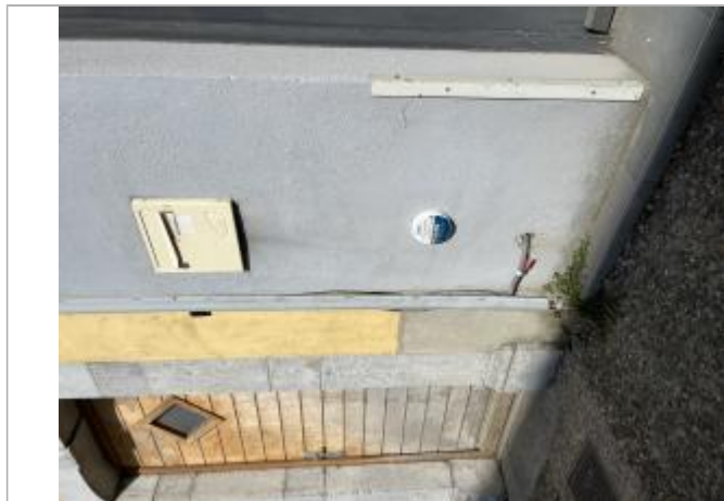
Repère de crue - façade 19 Rue de la République
