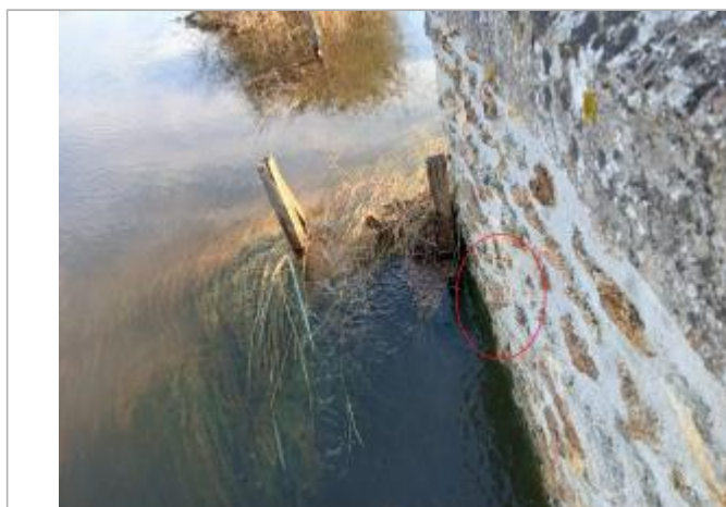
Laisse sur le mur du pont.
