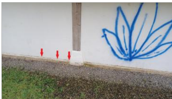
Laisse de crue à 29 cm/haut du rebord en ciment support de la poutre (voir photo).
