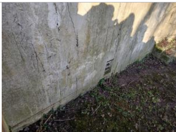
Laisse de crue à 243 cm en dessous du parapet du pont ou 134 cm/sol du pont.
