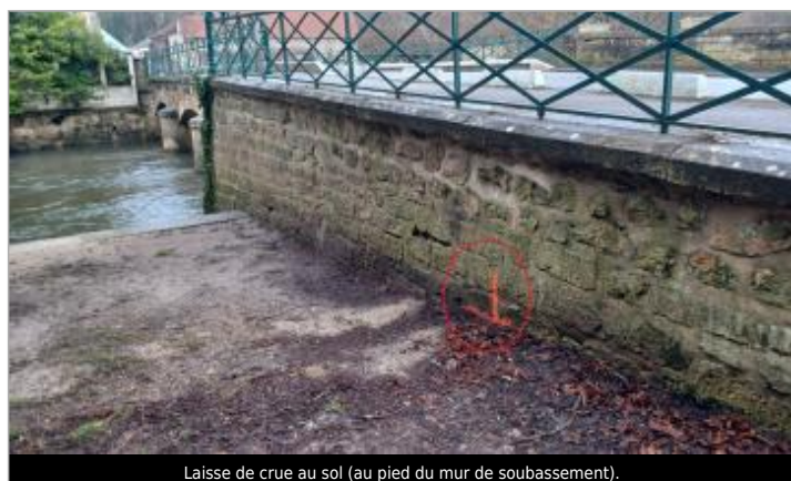
Laisse de crue au sol (au pied du mur de soubassement).
