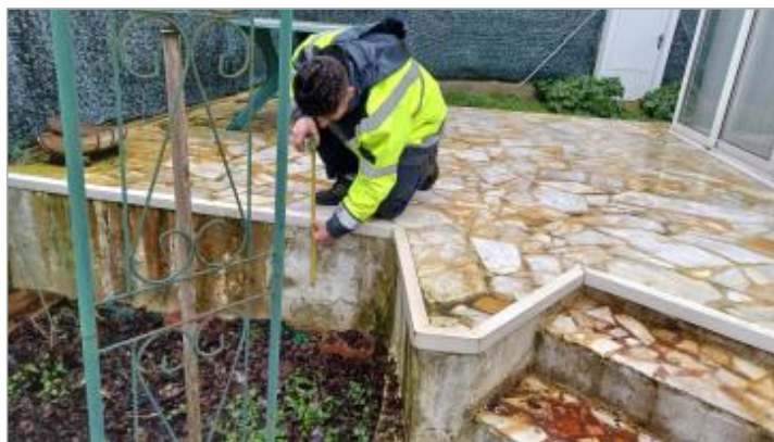
Laisse de crue à 32 cm/haut de la terrasse.
