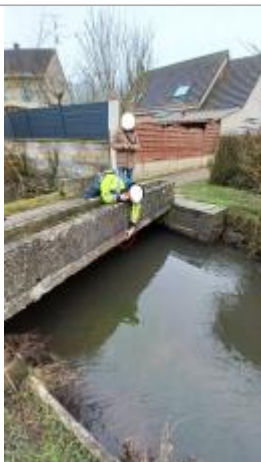
Laisse de crue à 13.5 cm/bas de la passerelle.
