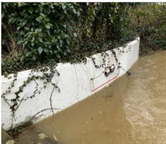
Photo d'un particulier prise en début de décrue. La trace au-dessus du repère de 1995.
