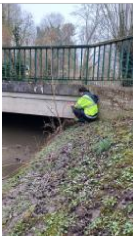
Laisse de crue à 80,5 cm/haut du tablier du pont.
