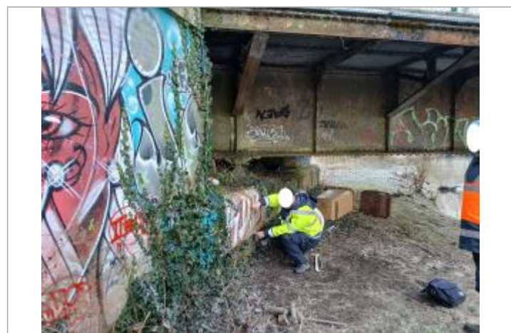
Laisse de crue à 3 cm/rebord du mur.
