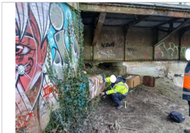
Laisse de crue à 3 cm/rebord du mur.
