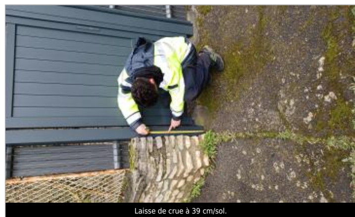
Laisse de crue à 39 cm/sol.
